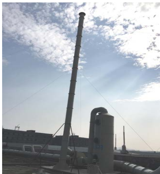
含氰废气处理设施
