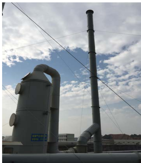
碱性废气处理设施
