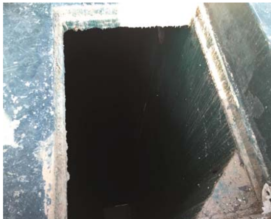
事故池检查口
