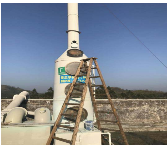
2#粉尘废气处理设施
