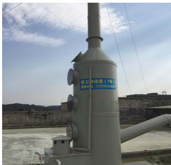
2#粉尘废气处理设施
