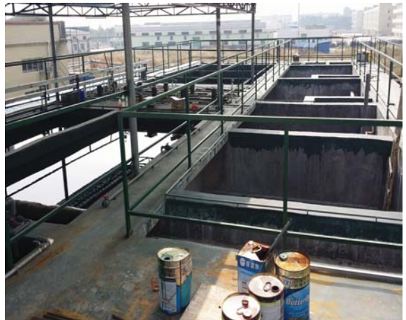
废水处理站全景
