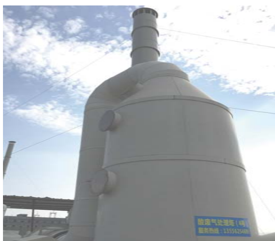
酸性废气处理设施
