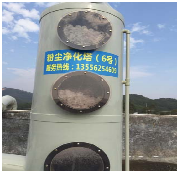
1#粉尘废气处理设施 1
