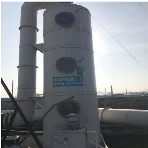
含氰废气处理设施
