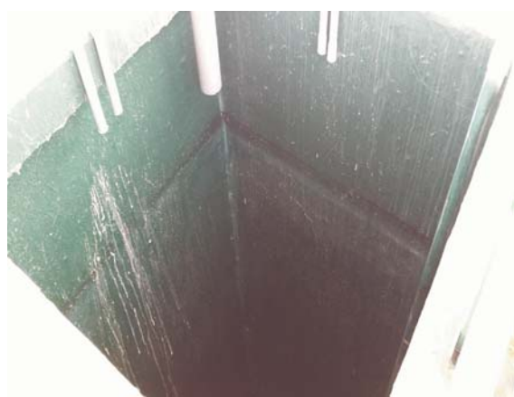
废水地下收集池
