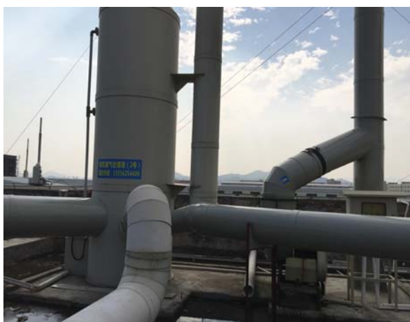
有机废气处理设施 1
