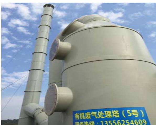
有机废气处理设施 2
